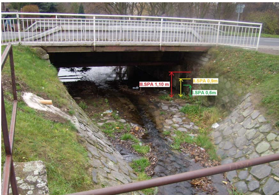
Foto č. 5: Podmileský potok – Hlásný profil pro potvrzení SPA v ř. km 0,77.
